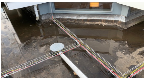
Verhoogde kabelgoten op het dak. Foto: SOBH
